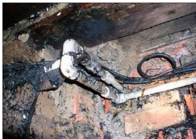
Ohřev tohoto plastového potrubí PB hořákem měl za následek požár rodinného domu
