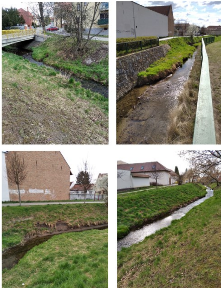
Obr. č. 41: Ukázka sesuvů svahů a následné usazování zeminy v korytě
