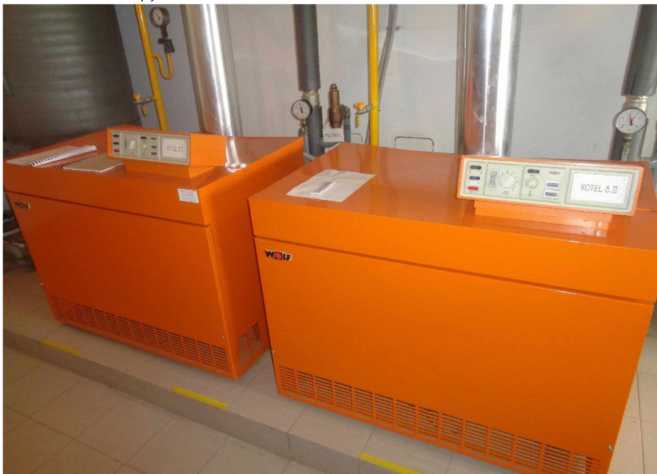
Obrázek č. 2.1.3.2: Záložní plynové kotle
