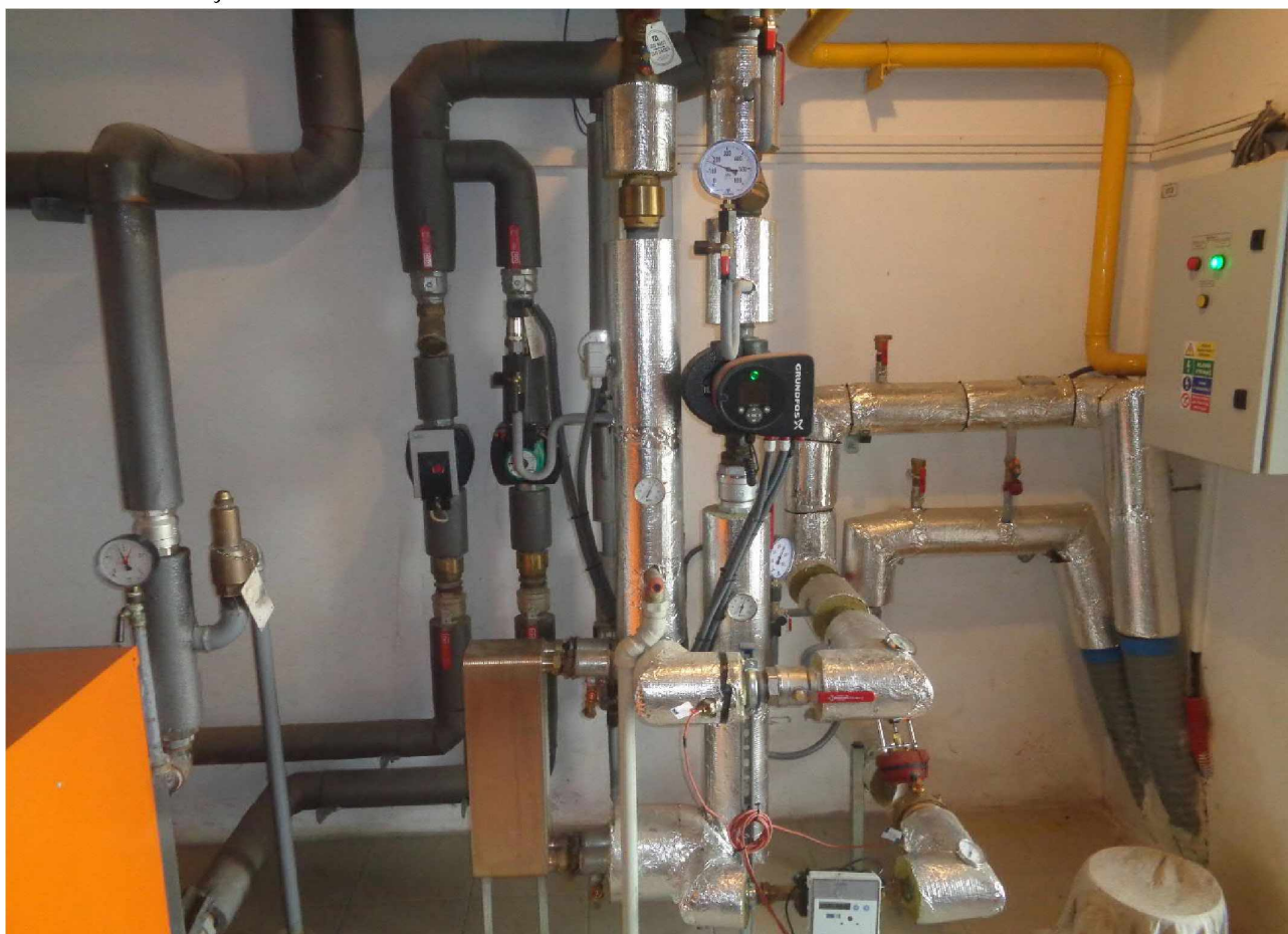
Obrázek č. 2.1.3.1: Výměníková stanice
