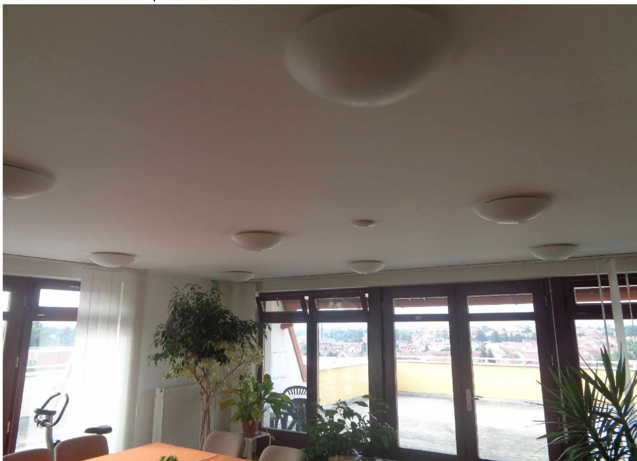
Obrázek č. 2.1.3.4: Osvětlení společné místnosti
